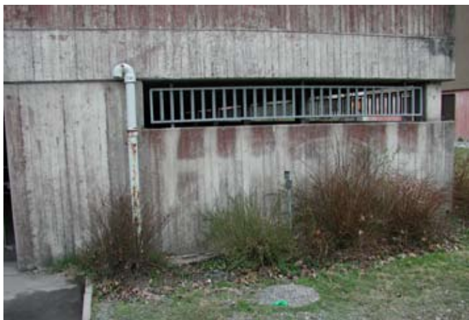
Parkeringshus av betong med röd alg, provyta behandlad med Grön-Fri
