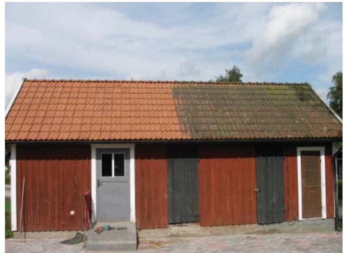
2 år efter behandling med Grön-Fri. Ingen tvättning av ytan har gjorts.
