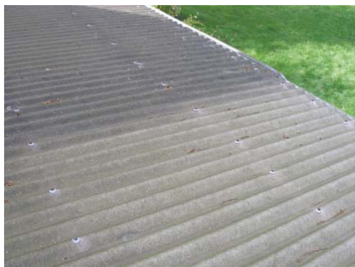
Tak av halvgenomskinlig glasfiber, 2 år efter behandling med Grön-Fri
