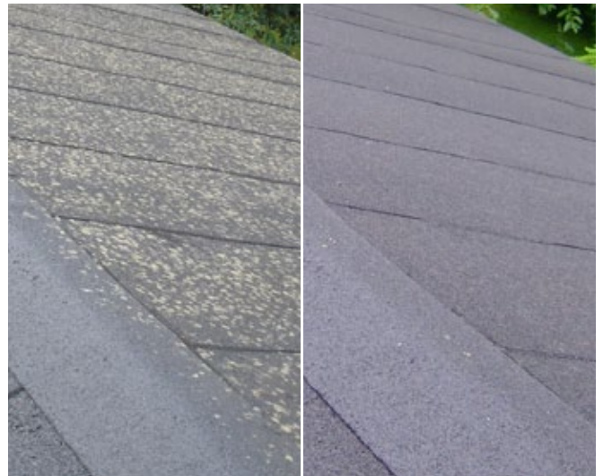
Tak av papp med angrepp av lav. 3 år efter behandling av Grön-Fri. Inget efterarbete.
