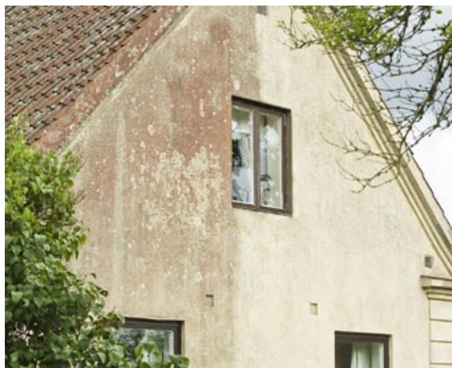
Putsad fasad med angrepp av rödalger. 4 månader efter behandling av Grön-Fri. Inget efterarbete.
