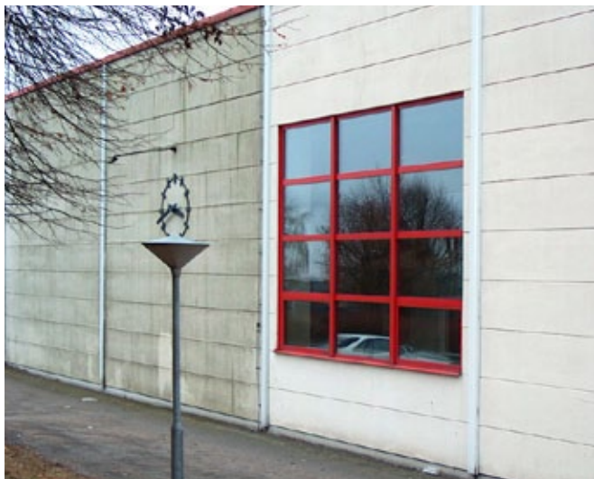
Vägg av lättbetong med angrepp av gröna alger. 10 månader efter behandling av Grön-Fri. Inget efterarbete.
