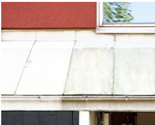
Plåttak med angrepp av alger. 12 månader efter behandling av Grön-Fri. Inget efterarbete.
