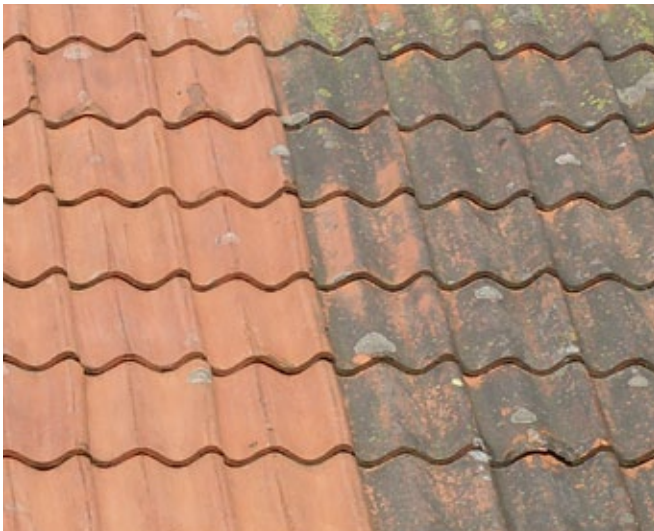
Tak av tegelpannor med angrepp av alger och lav. 2 år efter behandling av Grön-Fri. Inget efterarbete.
