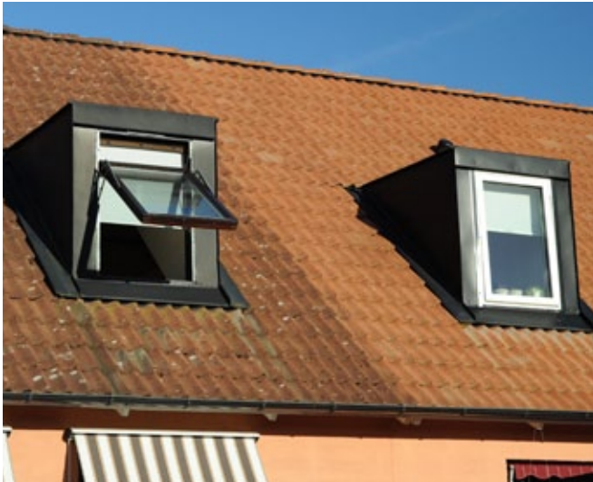
Tak av betongpannor med angrepp av alger och lav. 2 år efter behandling av Grön-Fri. Inget efterarbete.
