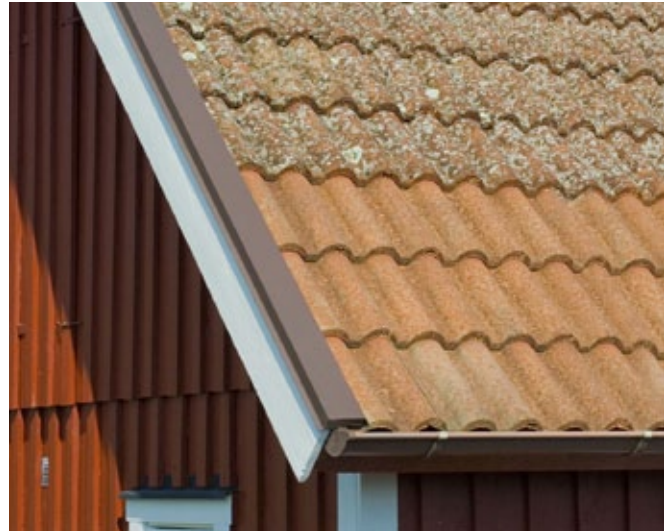
Tak av betongpannor med angrepp av lav. Två år efter behandling av Grön-Fri. Inget efterarbete.
