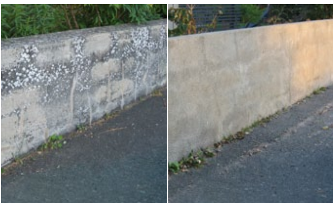
Putsad mur med angrepp av lav behandlad med Grön-Fri. Inget efterarbete. Vänster: Innan behandling. Höger: 4 år efter behandling.
