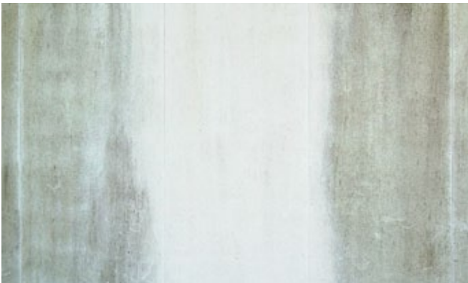
Mineralisk fasadskiva med angrepp av gröna alger. 18 månader efter behandling av Grön-Fri. Inget efterarbete.
