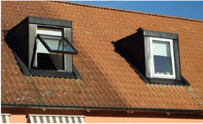
Tak av betongpannor med angrepp av alger och lav. 2 år efter behandling av Grön-Fri. Inget efterarbete.
