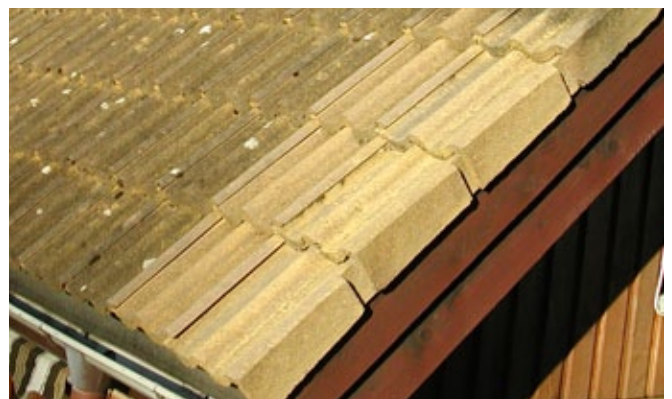
Gula betongpannor med påväxt av alger. Ca 2 år efter behandling med Grön-Fri. Inget efterarbete.
