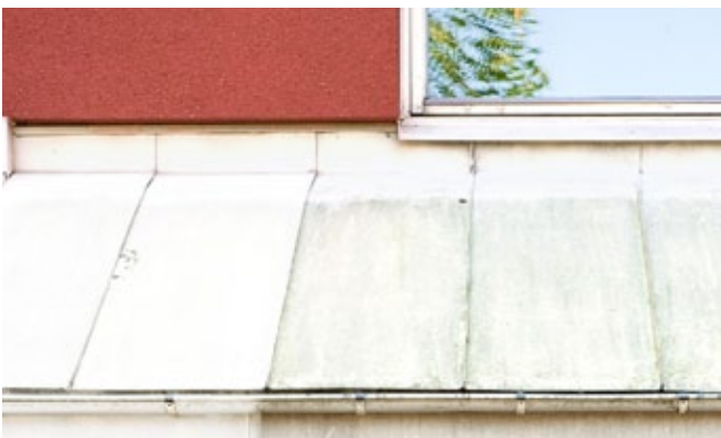
Plåttak med angrepp av alger. 12 månader efter behandling av Grön-Fri. Inget efterarbete.
