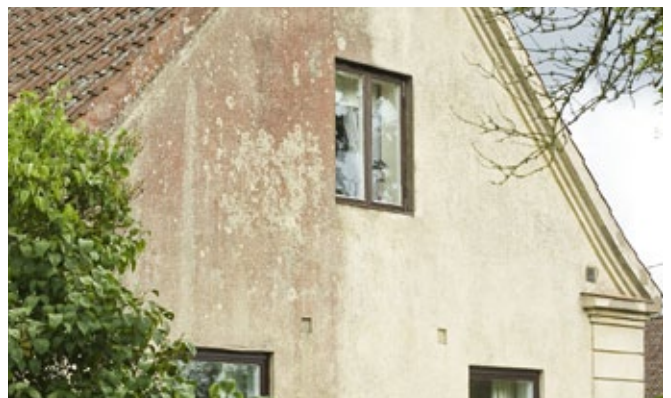
Putsad fasad med angrepp av rödalger. 4 månader efter behandling av Grön-Fri. Inget efterarbete.
