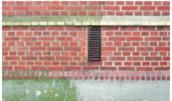
Tegelvägg med angrepp av gröna alger. 12 månader efter behandling av Grön-Fri. Inget efterarbete.
