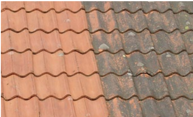
Tak av tegelpannor med angrepp av alger och lav. 2 år efter behandling av Grön-Fri. Inget efterarbete.
