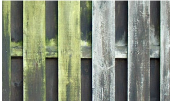
Målat träplank med angrepp av gröna alger. Ett dygn efter behandling av Grön-Fri. Inget efterarbete.
