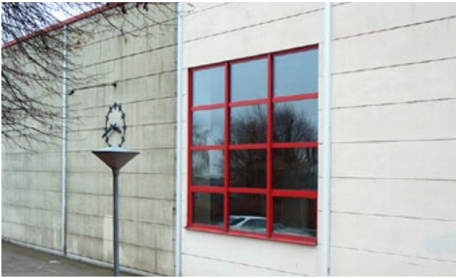
Vägg av lättbetong med angrepp av gröna alger. 10 månader efter behandling av Grön-Fri. Inget efterarbete.
